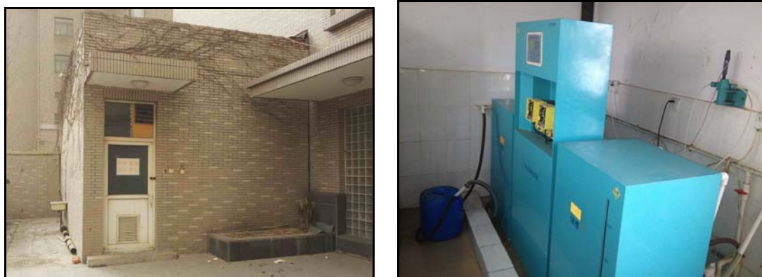
图 4.1-5 第二住院部现状污水处理站
