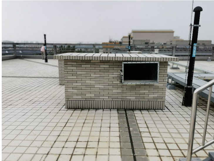
图 4.1-7 检验科实验废气排放口
