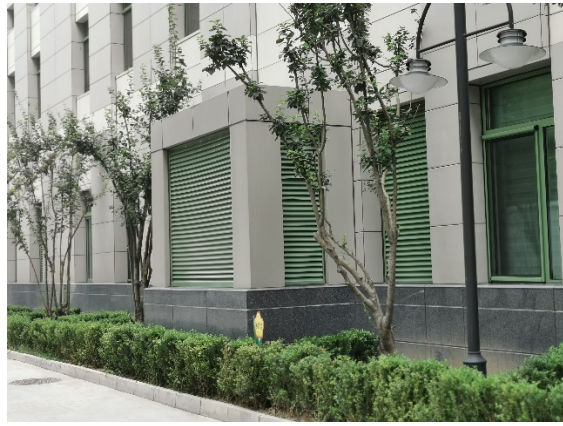
地下车库废气排放口（西侧）
