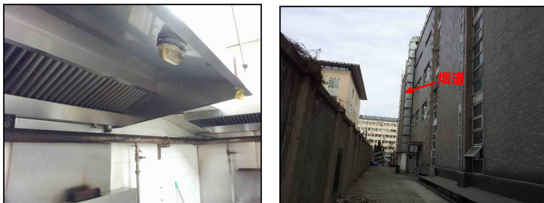
图 4.1-3 第二住院部餐厅油烟净化器及排气口
