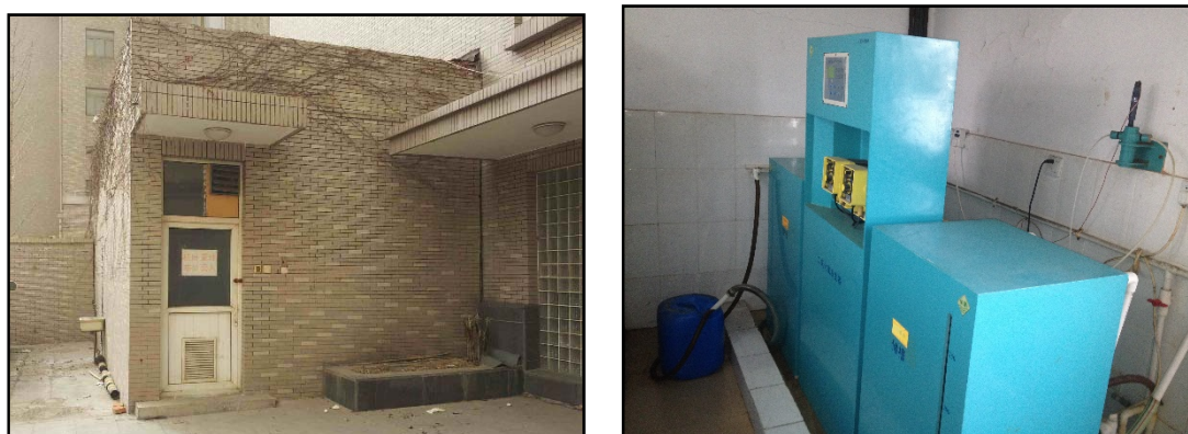
图 4.1-8 第二住院部现状污水处理站
