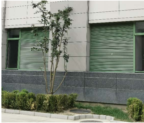
地下车库废气排放口（南侧）
