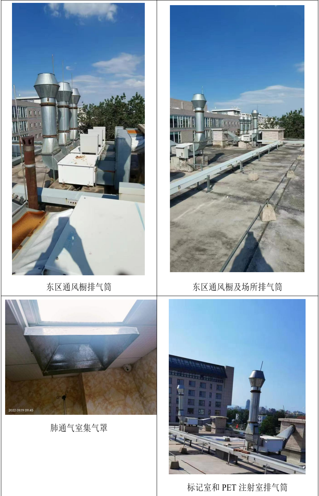
图 4-3 核医学科放射性废气措施照片
