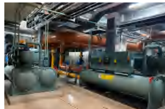
第二住院部制冷机房
