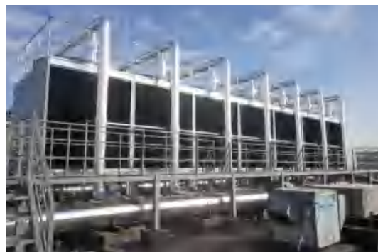
第二住院部冷却塔
