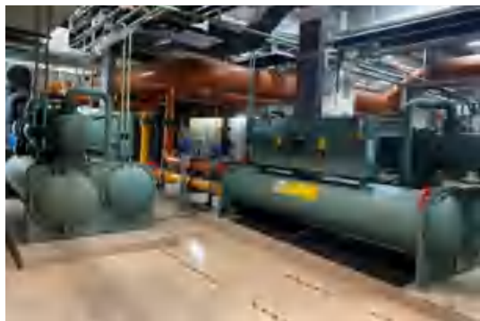
大型装备巡检，落实安全生产，完善动力保障
