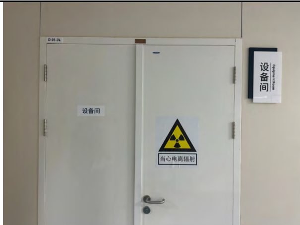
设备间防护门外设置的放射性标志、中文警示说明
