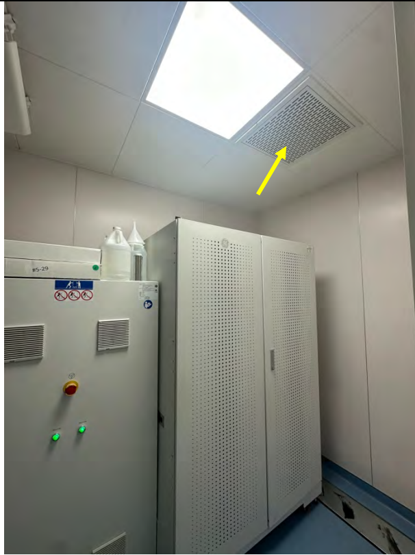
机房内通风系统
