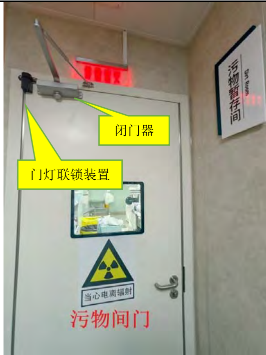
污物间门外放射性标志和中文警示说明、“射线有害 灯亮勿入”警示灯、门灯联锁触点、闭门器、门上铅玻璃观察窗
