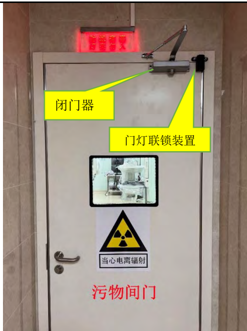
污物间门外放射性标志和中文警示说明、“射线有害 灯亮勿入”警示灯、门灯连锁触点、闭门器、门上铅玻璃观察窗
