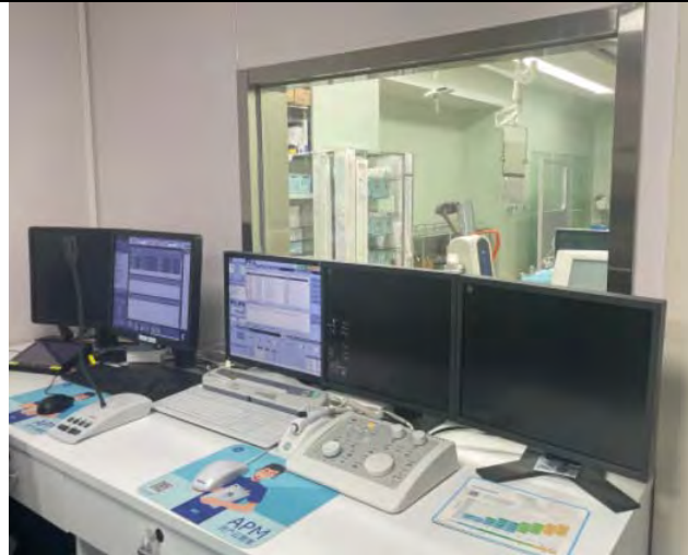
控制室铅玻璃观察窗
