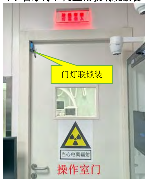
控制室门外放射性标志和中文警示说明、“射线有害 灯亮勿入”警示灯、门灯联锁触点、门上铅玻璃观察窗
