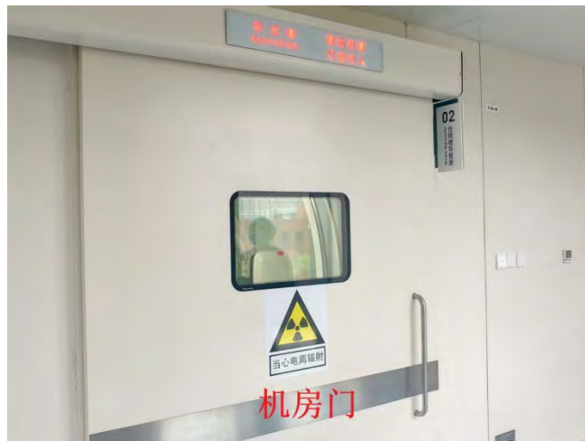
患者防护门外放射性标志和中文警示说明、“射线有害 灯亮勿入”警示灯、门上铅玻璃观察窗
