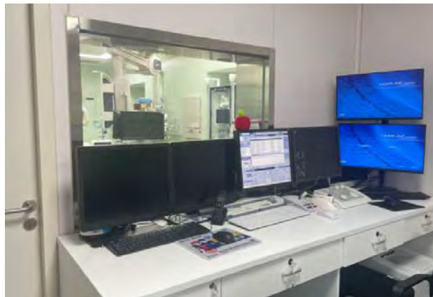
控制室铅玻璃观察窗
