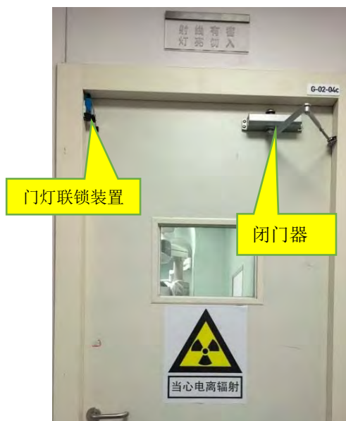
控制室防护门外设置的放射性标志和中文警示说明、“射线 有害 灯亮勿入”警示灯，门上设铅玻璃观察窗、闭门器、门 灯联锁触点
