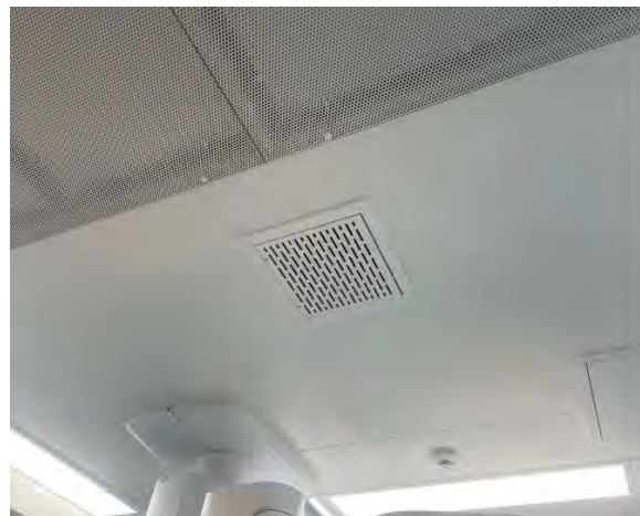
机房内通风口
