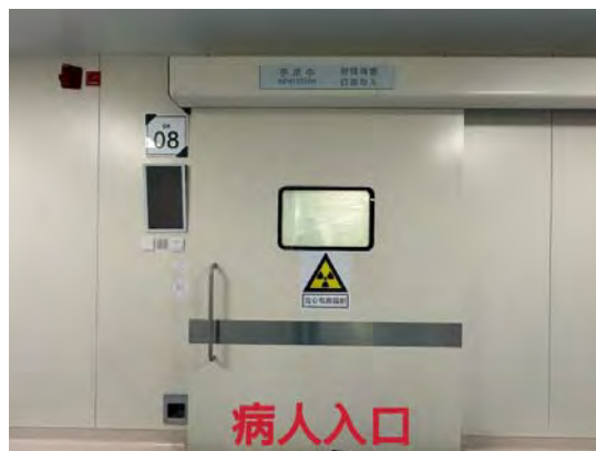
患者出入口设置的放射性标志和中文警示说明、“射线有害 灯亮勿入”警示灯、门上设铅玻璃观察窗
