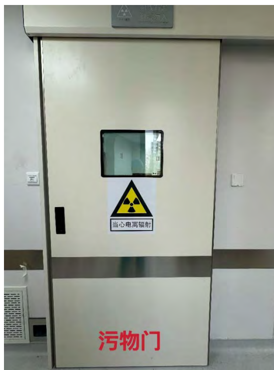
污物通道防护门外设置的放射性标志、中文警示说明，门上设铅玻璃观察窗
